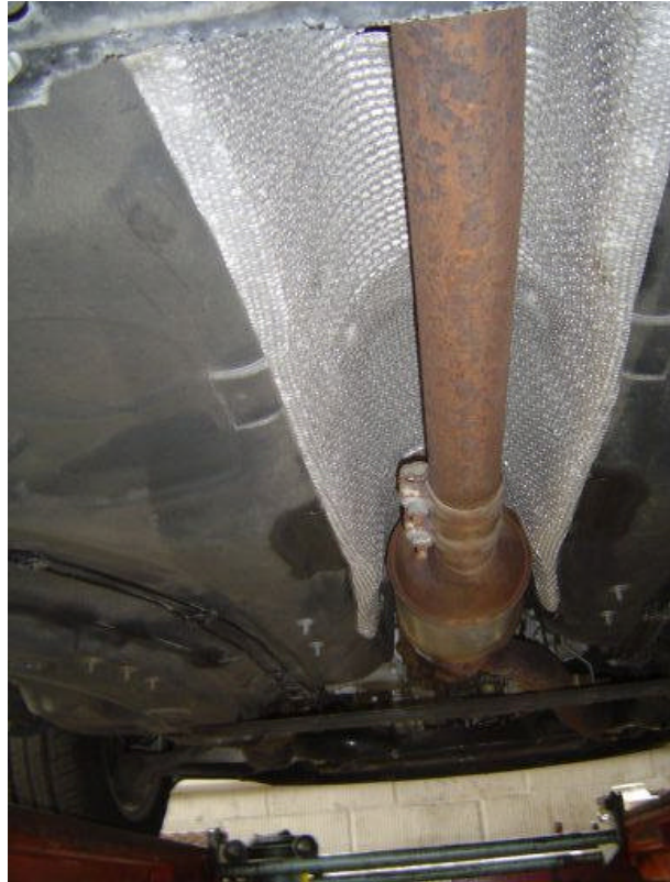
Pöl-Vorlauf und -Rücklauf hinter dem Hitzeschild im Fahrzeugtunnel
